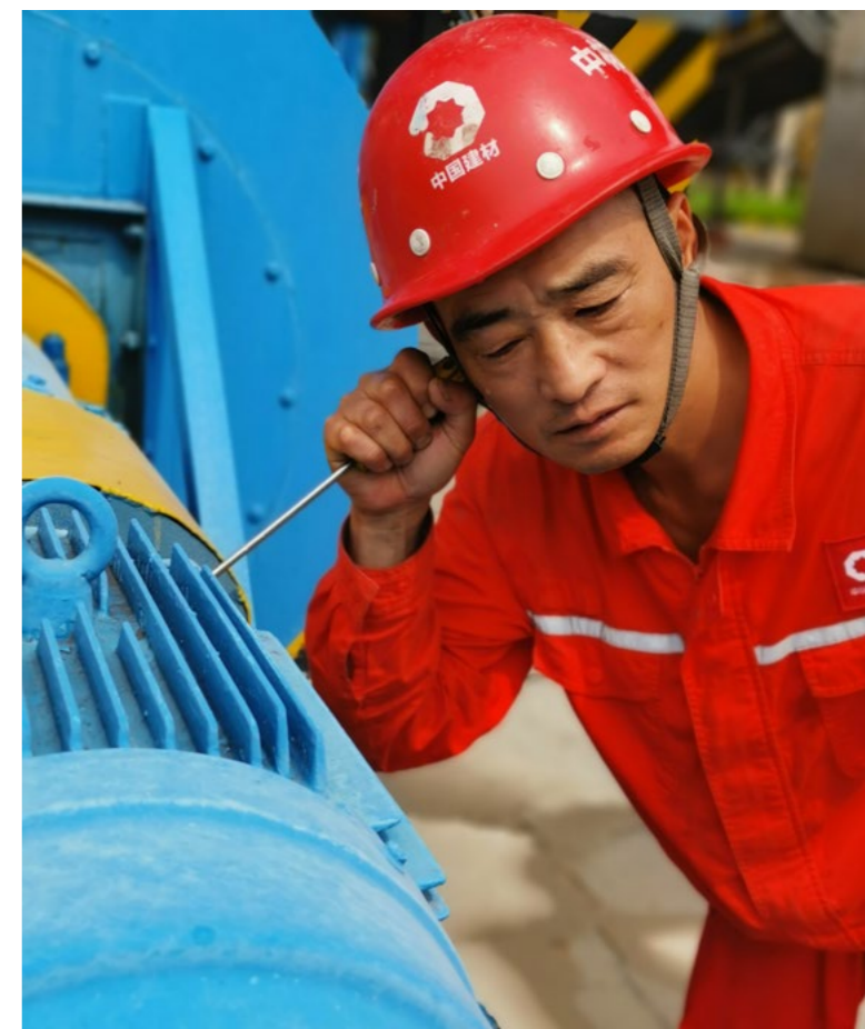
中材安徽水泥有限公司骨料电气工段长陈小保正在户外对骨料电气设备进行巡检维护，记录巡检和维护情况，及时排除隐患，确保电气设备安全稳定运行
