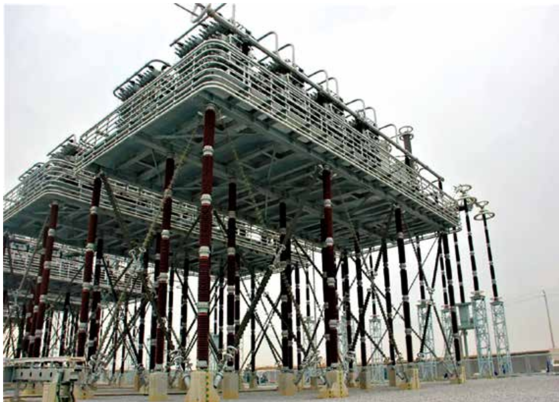
瓷支柱绝缘子应用于荆门1000千伏特高压工程
