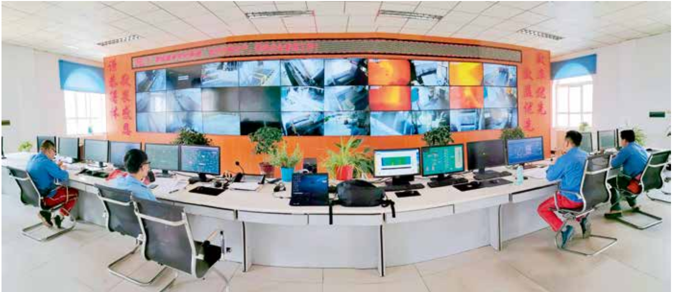
太阳山生产区中控室
