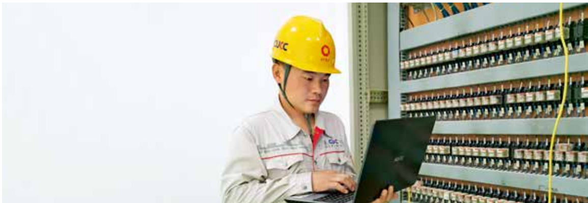
姬海军正在下装DCS现场站程序, 维护设备正常运行
