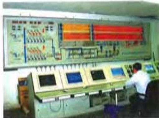
西安院总包的山西阳泉南煤集团自动化控制室
